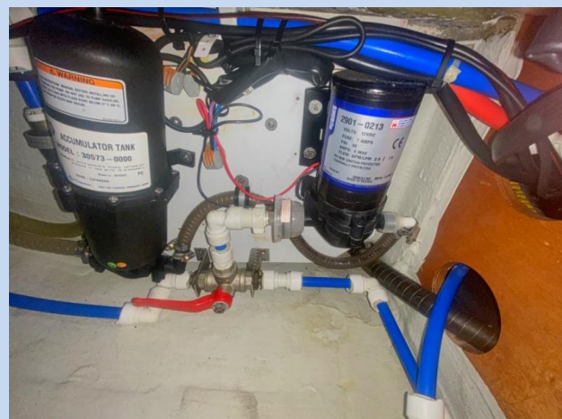
Druckbehälter und Wasserpumpe mit Umschaltventil
