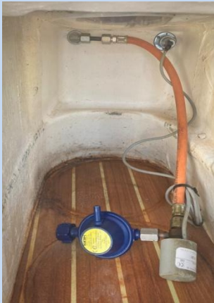
Sicherheitsventil, Druckminder und Gasfernabschaltung (Magnetventil)
