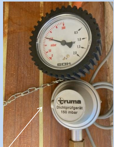
Jährliche Gasdichtigkeitsprüfung mit dem Dichtigkeitsprüfgerät 150mb von der Fa. Truma
